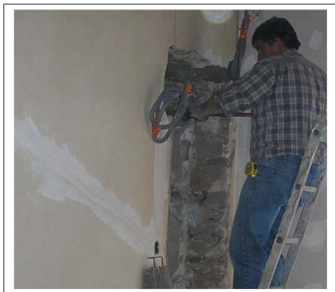
Agrandissement de la porte du 1er étage par le maçon Eric MARAND
